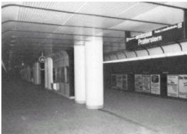
Tokyo, métro - [plafond acoustique en métal]
